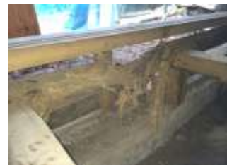
↑土台が腐朽しています
