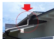
↑集水桝を増設
